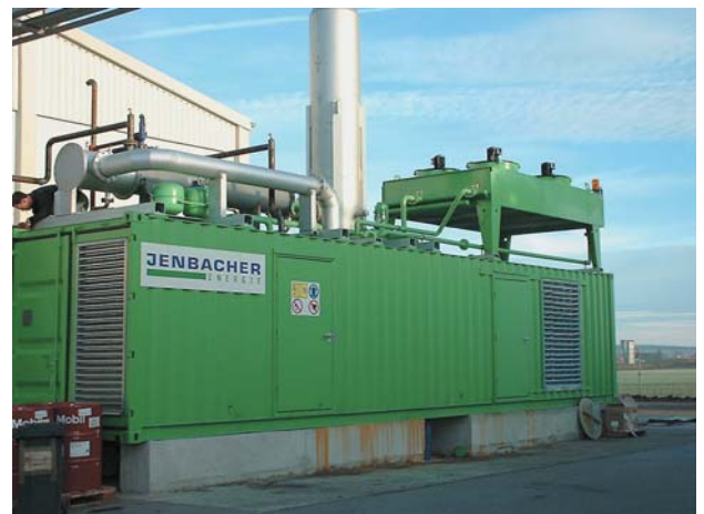
Ein Jenbacher BHKW der Bio-Energie Schwaben
